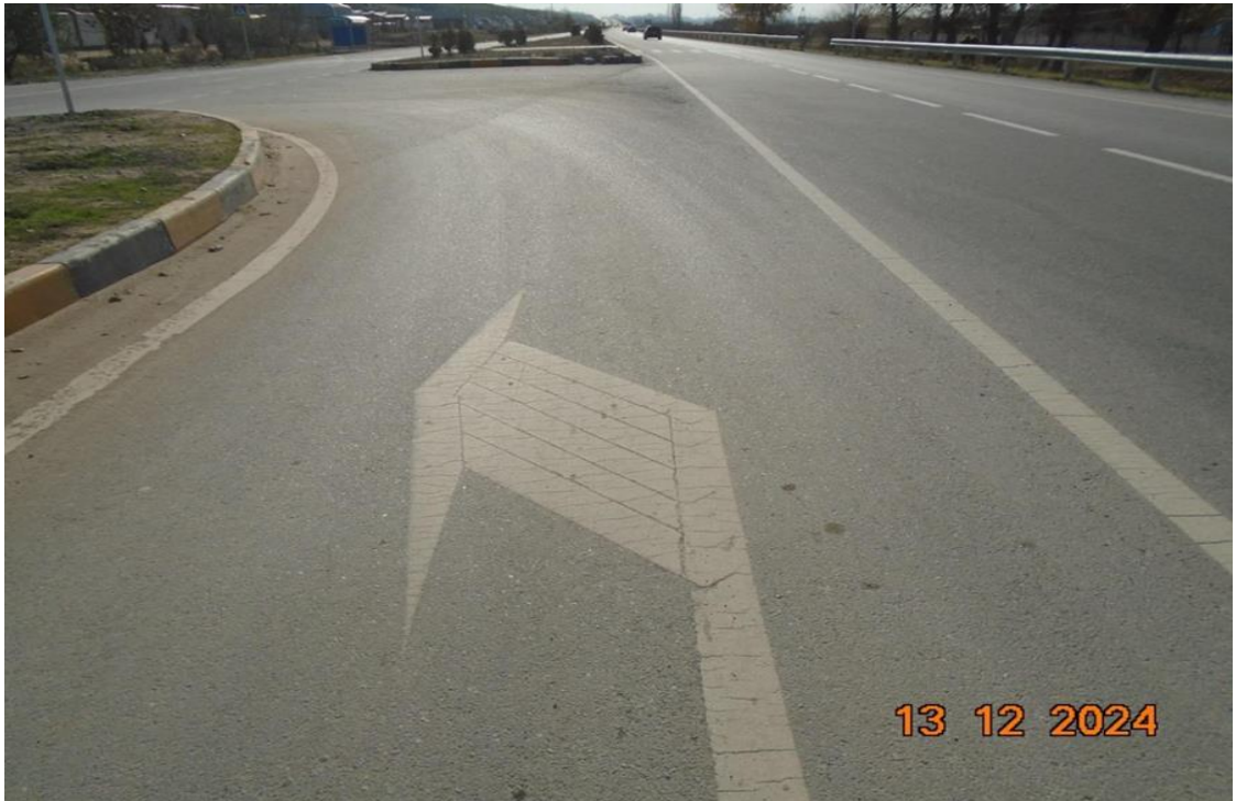
Фото 11. . Км43-83. Пример повреждения боковой кромки бордюрного островка в начале разворота в результате столкновения с транспортным средством.
