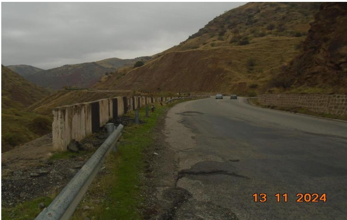
Фото 4. Км 48.4ПС. Пример недавно поврежденного ограждения, требующего срочного ремонта/замены.
