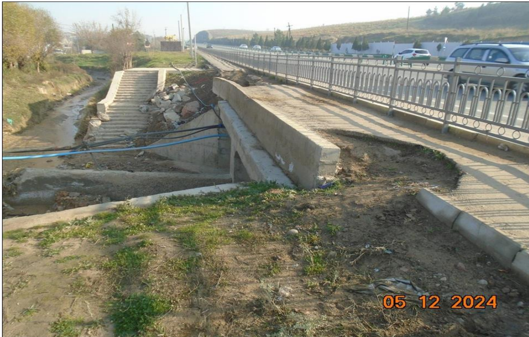
Фото 3. Контракт СР-05. Дорога Душанбе-Турсунзода км16. Ремонт пешеходного подземного перехода, поврежденного селевым потоком в 2024 году, о чем было упомянуто подрядчику.
