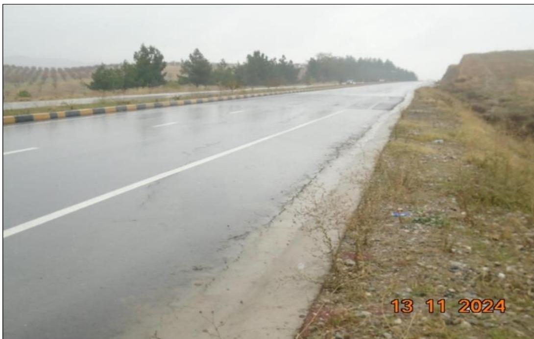
Фото 7. Км 27,2 ЛС. Пример недавней серьезной деформации дорожного покрытия из-за просадки/эрозии края дорожной насыпи, возможно, из-за сильных потоков с прилегающих полей, требующей уплотненной обратной засыпки и дренажа с облицовкой.
