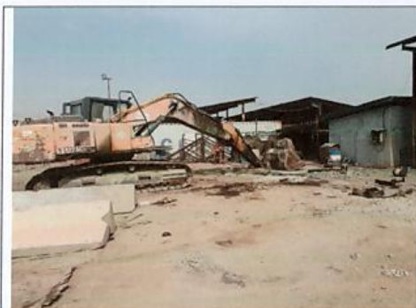
Состояние рабочего лагеря во время совместной проверки 14 октября 2024 года
