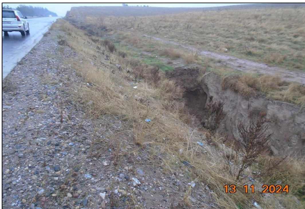
Фото 8. Крупный план трубопровода/эрозии на участке 7, возможно, из-за сильных потоков с соседних полей, требующих уплотненной засыпки и облицованного дренажа.
