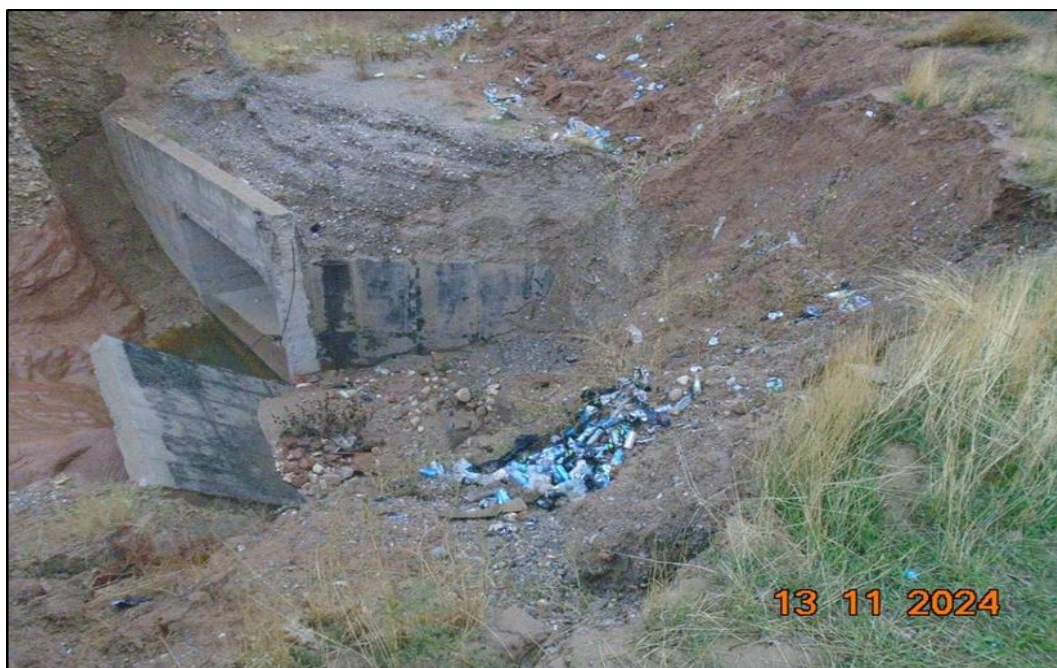
Фото 10. Км 41,2 ЛС. Пример недавно поврежденного водопропускного сооружения и высокого края дорожной насыпи из-за эрозии верхней части дороги ливневыми потоками с большого водосбора, что потребовало восстановления упавшего крыла, уплотненной обратной засыпки и облицовки канала рядом с водопропускным сооружением.
