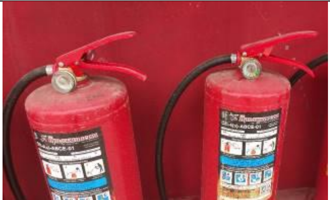
Фото 11: Пожаротушение на месте, октябрь 2022 г.
